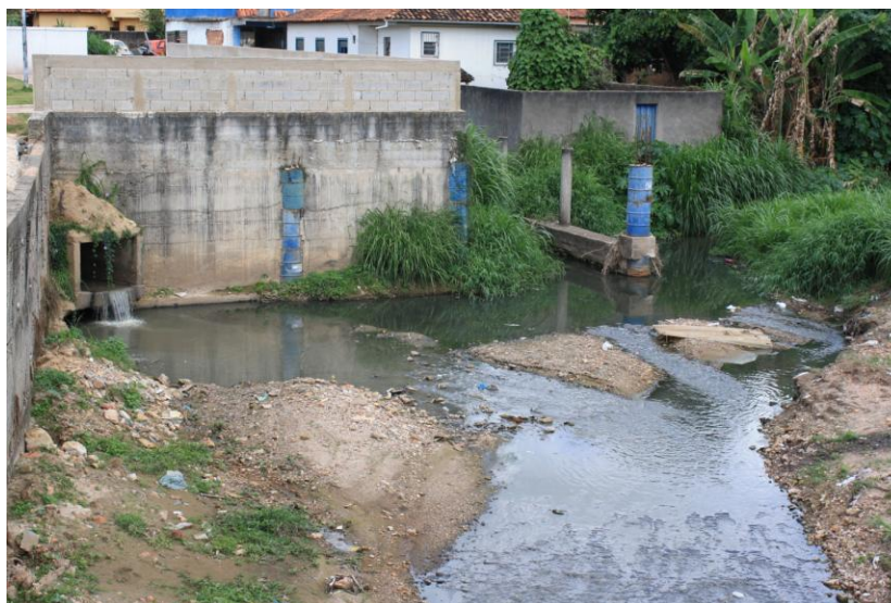
Fig.01: Rio Grande - Diamantina/MG: Construções que descaracterizam o leito do rio e despejo de esgoto in natura .
